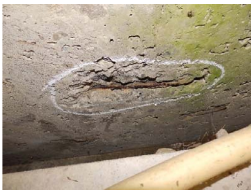
写真 3-1 中性化による損傷状況 (高賀野 2 号橋・床版)
