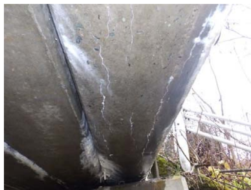
写真 3-2 凍害による損傷状況 (小根沢 2 号橋・主桁)
