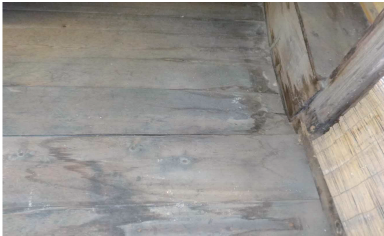
※床板・基礎腐食
