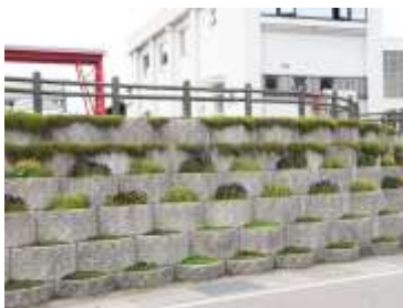
擁壁を階段状にし、緑化による修景を行うことで圧迫感を軽減している例
