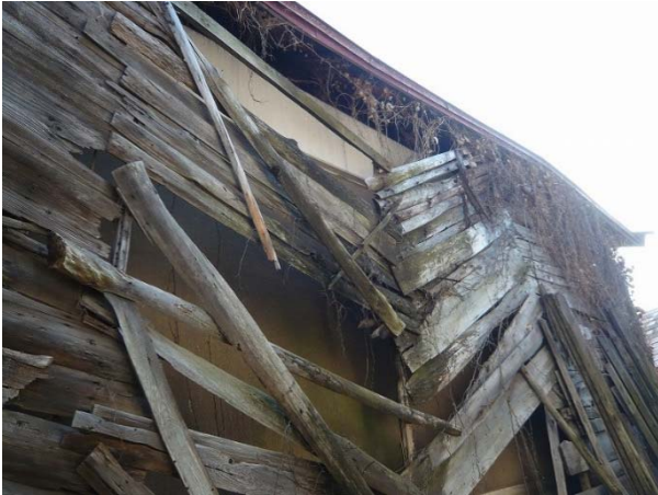
翰壁はほぼ崩壊状態であった（既存）
