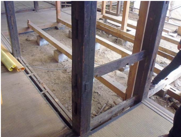
土台・大引きも新しい材が用いられ、コンクリート製束石の上に乗る。手前の渋墨塗りの軸組が創建時のものと考えられる（解体）
