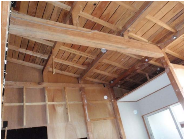
柱・梁・母屋・垂木・野地板等全てに同時期の新しい材料が用いられている（解体）
