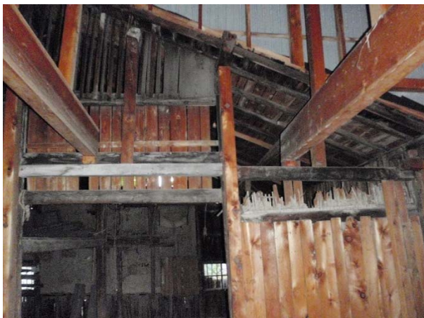
土蔵西側に隣接していた燃料庫。南に面した平入りに見えるが、屋根は蔵前と連続して後年掛けられたものであり、実際は南北に棟木の通った切妻屋根であった(既存)
