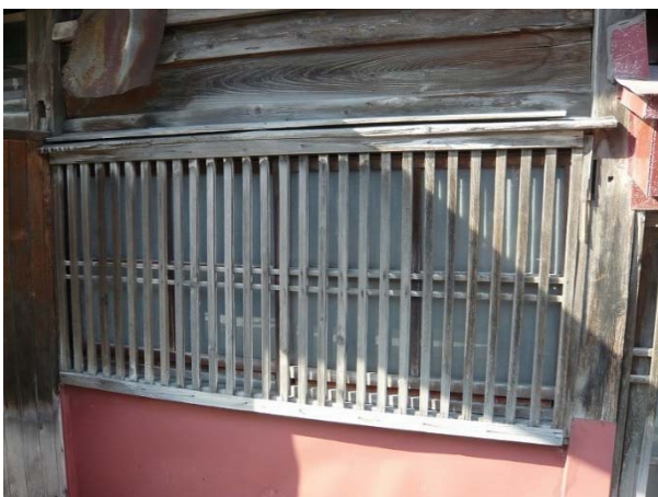
格子は油抜けして痩せており、一部に腐朽も見られる。格子の内側の建具は比較的良好な状態で残されている。
