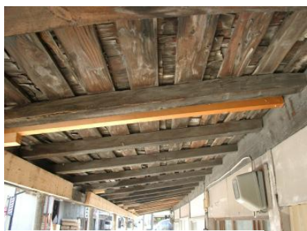
こみせ軒下部の腐朽
